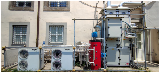
Fig. 3 - Impianto di climatizzazione sperimentale del laboratorio SENS i-Lab del DADI per lo sviluppo di metodi automatici di fault detection and diagnosis | Heating Ventilation and Air-Conditioning (HVAC) set-up of the SENS i-Lab of DADI for the development of automated fault detection and diagnosis methods.
