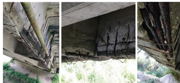
Fig. 3 - Esempi di ossidazione significativa di barre di armatura in ponti esistenti in c.a. | Examples of significant oxidated reinforcement bars in existing R.C. bridges.
