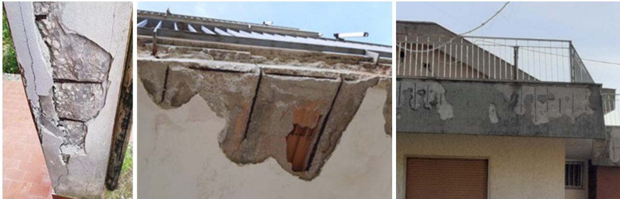
Fig. 4 - Esempi di degrado significativo di elementi in c.a. negli edifici | Examples of significant degradation of reinforced concrete elements in buildings.
