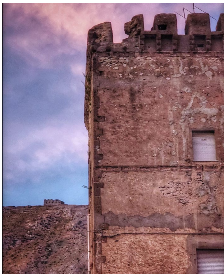
Fig. 10- Mondragone (Ce), torre ducale, particolare della fronte su corso Umberto I. Le condizioni di conservazione dei merli d'angolo, ormai quasi del tutto scomparsi, destano forte preoccupazione (A. Razzano, 2019).
