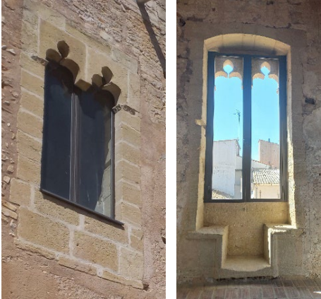
Fig. 10- Exterior e interior de una ventana aljimezada del castillo de Llutxent. En el exterior se observa la imposta con rosetones de la jamba. En el interior se observan los «festejadores» (Concepción López, 2024).
