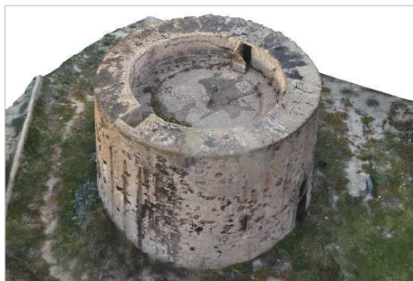
Fig. 6- Restituzione tridimensionale realizzata con foto da drone della Torre Scollato in cui è possibile desumere alcuni degradi causati da un lungo abbandono.
