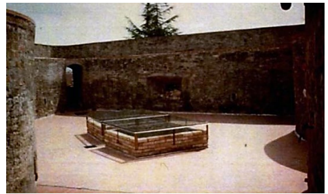
Fig. 10- Punta Santa Maria Maddalena dopo il restauro: lo spalto con le due aperture quadrate dei camini per i fumi di volata (Archivio Taddei, 1997).
