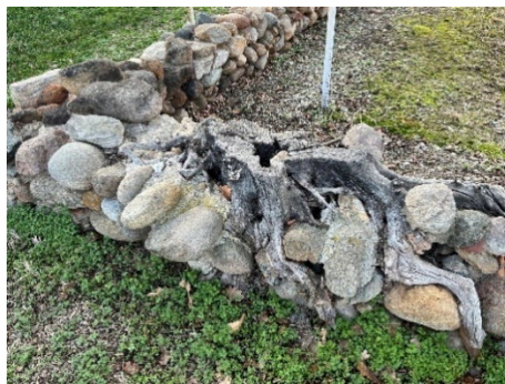
Fig. 5- Degrado delle murature nell'Edificio VI. Vegetazione con consistenti apparati radicali (Giorgia Gentilini, 2024).
