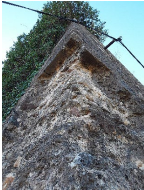
Fig. 14- Expolio y cableado eléctrico en el bastión noreste (Fotografía del autor, 2018).
