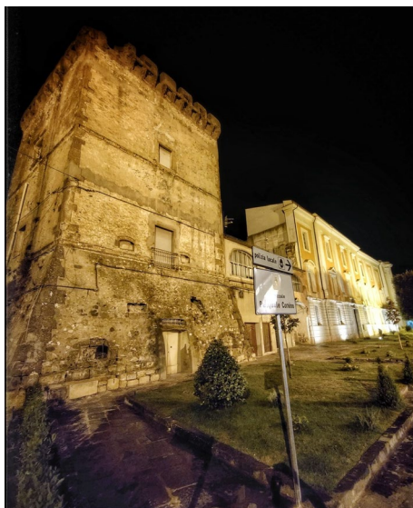
Fig. 9- Mondragone (Ce), scorcio di torre e palazzo ducale. Le superfici esterne della struttura turrita sono interessate da diverse patologie di degrado, quali: distacco o mancanza di elementi lapidei; vegetazione infestante erbacea; patina biologica; lacune di intonaco; alterazione cromatica (A. Razzano, 2022).
