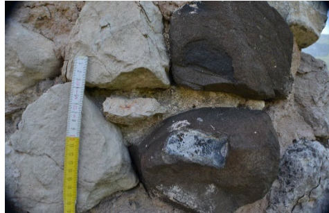
Fig. 5- Caso I. Composizione del giunto di connessura originario in calce aerea (foto di Isabella Zamboni, 2010).
