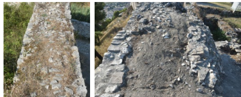
Fig. 9- Copertine murarie non protette a diverso livello di disgregazione delle malte con perdita dei sacchi murari (foto dell'autore, 2024).
