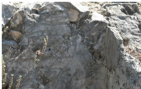
Fig. 7- Lacerti di intonaco superstiti in corrispondenza di una porzione muraria recentemente dissotterrata (foto dell'autore, 2024).
