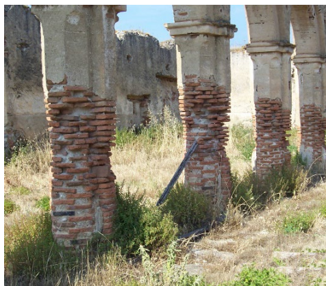
Fig. 5- Strutture deteriorate da forme di degrado (foto degli autori, 2024).
