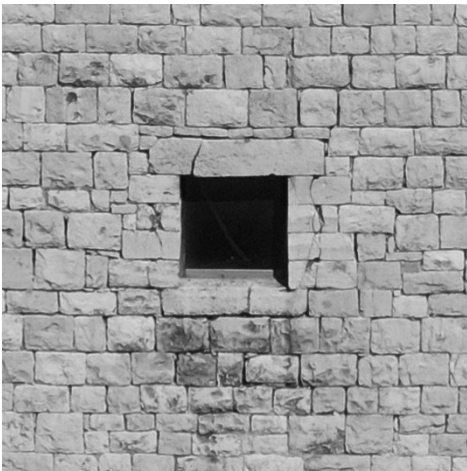
Fig. 5- La stessa apertura vista nella Fig. 4 ora vista dall'esterno. Sono evidenti le manipolazioni della muratura circostante l'apertura (foto dell'autore, 2024).
