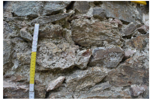
Fig. 11- Caso III. Composizione e finitura dei giunti originali in calce aerea (foto di Isabella Zamboni, 2010).
