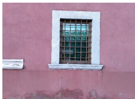
Fig. 6- Intonaco cementizio nella fascia bassa dell'edificio e fenomeni di degrado correlati (A. Di Paola, 2022).
