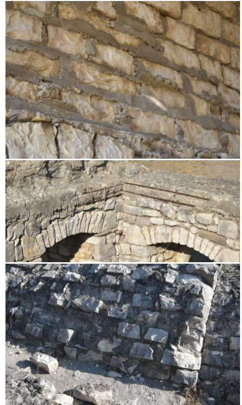
Fig. 10- iperconsolidamenti, inglobamenti e cementature di porzioni murarie in loco ed in ricostruzione (foto dell’autore, 2024).
